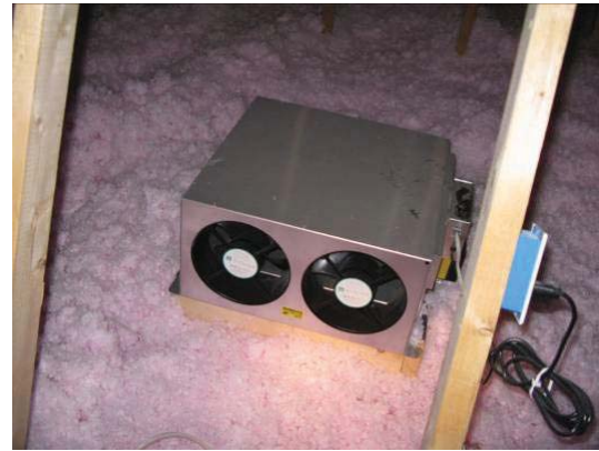
Whole house fan
