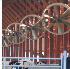
Calefacción, refrigeración y ventilación de las instalaciones
