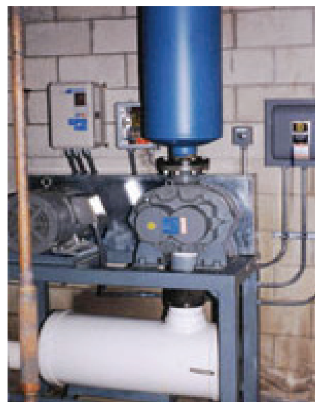
Bomba de vacío de leche y VFD.
