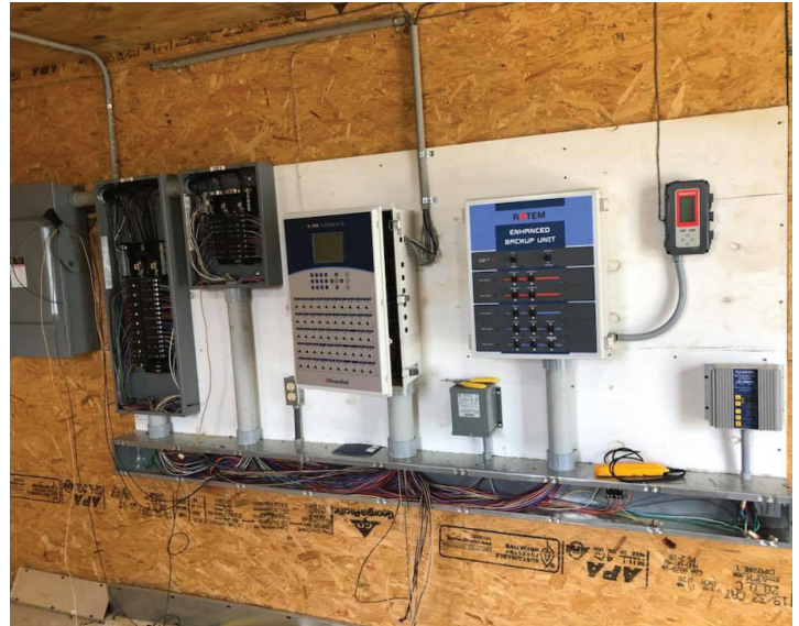
Controladores de iluminación para instalaciones y usos múltiples.
